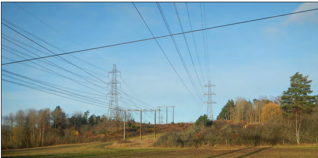
Figur 12. Foto över befintliga luftledningarna på delsträcka 1, fotokning norrut. Från vänster: Svenska kraftnäts två 400 kV ledningar i fackverksstolpar, Sökandens två 70 kV ledningar L2 och L3 i träportalstolpar, Sökandens två 70 kV ledningar L1 och L4 i fackverksstolpar.
