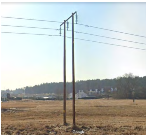
Figur 1. Befintlig luftledning, parallellt med Sandavägen (Källa: Google maps, 2022).
