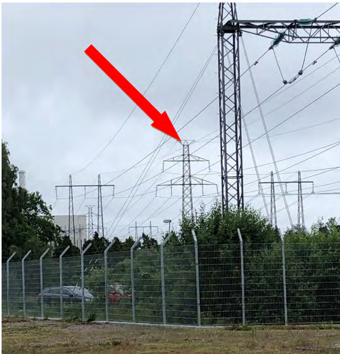
Figur 3. Foto mot aktuellt område. De aktuella ledningarna är sambyggda i stolpen i mitten i bild, röd pil. I bakgrunden syns OKG:s kärnkraftverk.
