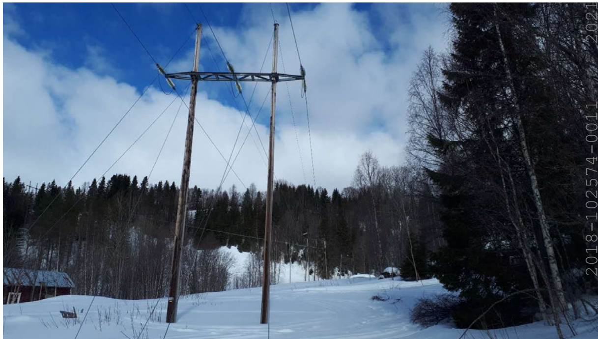
Bild 2. Visar avspänningsstolpen närmast före ställverket i Linnvasselv.
