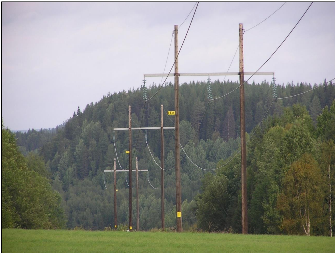
Figur 12. 130 kV ledning uppförd i träportalstolpar.
